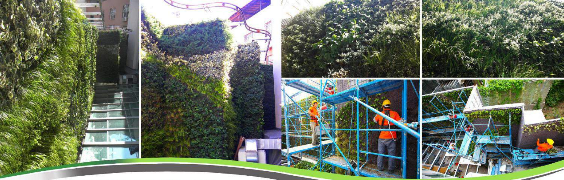
RADISSON BLU PERA OTELİ DIŞ MEKAN DİKEY BAHÇE UYGULAMASI
